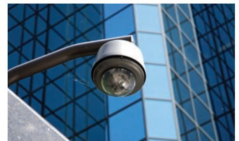
Telecamere di sorveglianza
